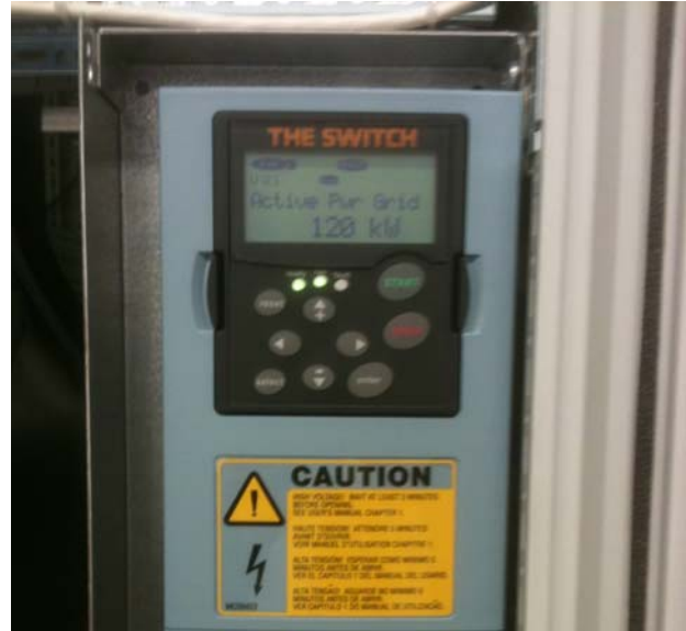
Grid Import Meter
