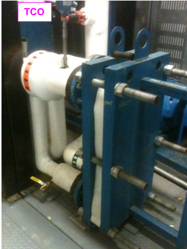
HX-01 (condensate preheater)
