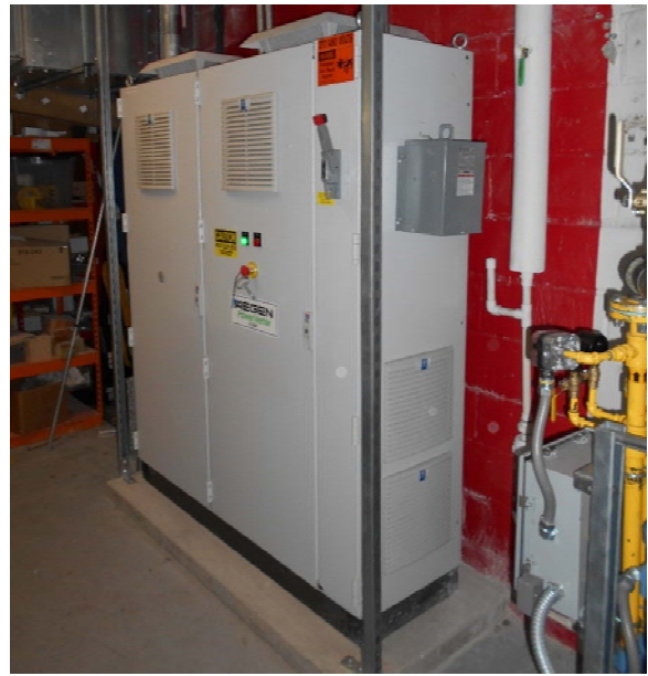
Aegis cogen unit inverter.
