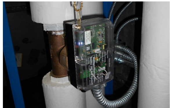
Badger 380 BTU meter (FHW, THW3).
