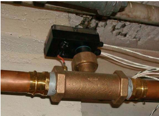
Badger 380 BTU meter (FHW, THW1, THW3).
